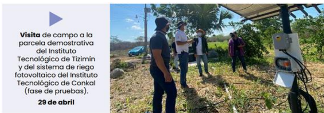
Figura 16. Instalación de sistema de riego fotovoltaico en parcelas demostrativa en Tizimín y Conkal.
