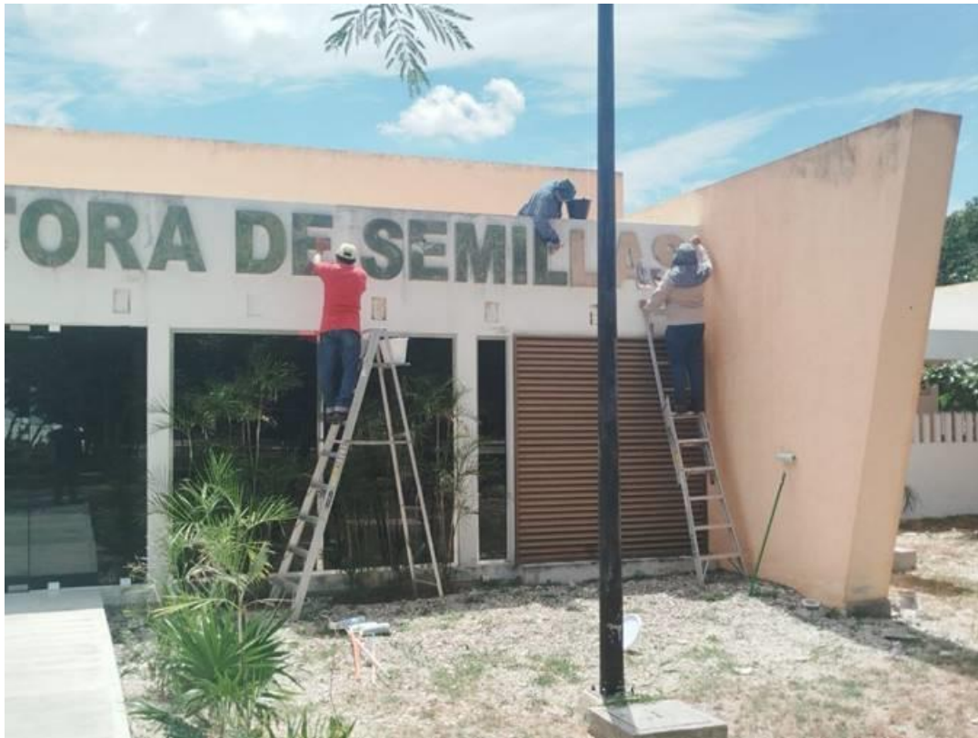
Figura 87. Inicio de los trabajos de pintura de la fachada principal de la UPS.
