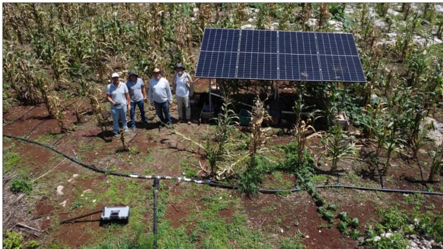
Figura 13. Implementación de tecnologías de bombeo y riego fotovoltaico.
